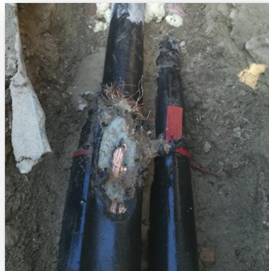
Uszkodzenie kabla 110kV przy wykonywaniu przewiertu dla przedsiębiorstwa wodociągowego
